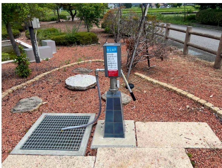
写真3 富山県内に設置されている防災井戸（あさひの郷公園）
